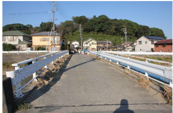
写真② 外城田川の増水により流下物が橋に架かっている様子 (色白橋)
