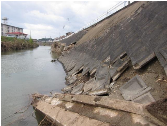
写真① 外城田川の増水で護岸が被災 (城東団地北側付近)
