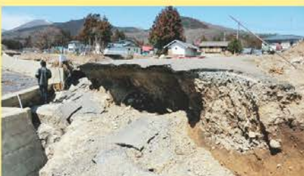
藤沼貯水池の決壊による被害
